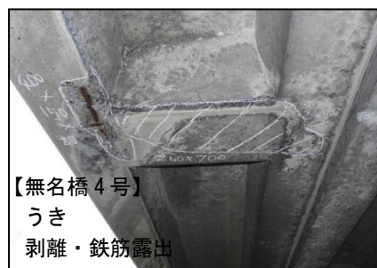
写真-5.4 損傷状況（コンクリート部材）
