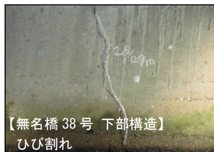
写真-5.5 損傷状況（下部構造）
