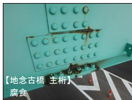
写真-5.3 損傷状況（鋼材）
