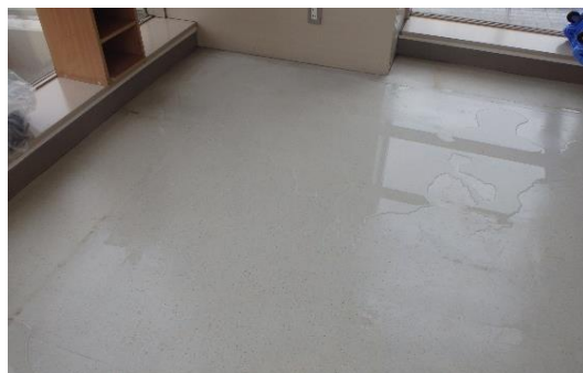
《壁を伝って床より浸水するロビー》
