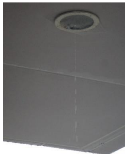
《玄関庇にあるダウンライトから滴る雨水》
