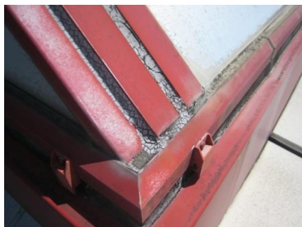
《トップライトのコーキング劣化》
