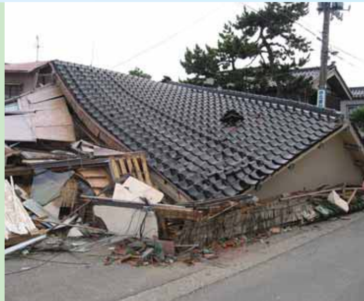
写真：「平成19年新潟県中越沖地震」の木造家屋被害状況(愛知県資料)
