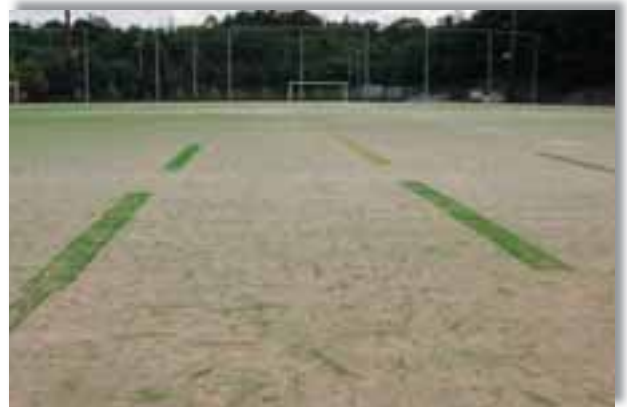
平成19年5月に人工芝の切れ目の一部分の補修を行った黒笹公園
