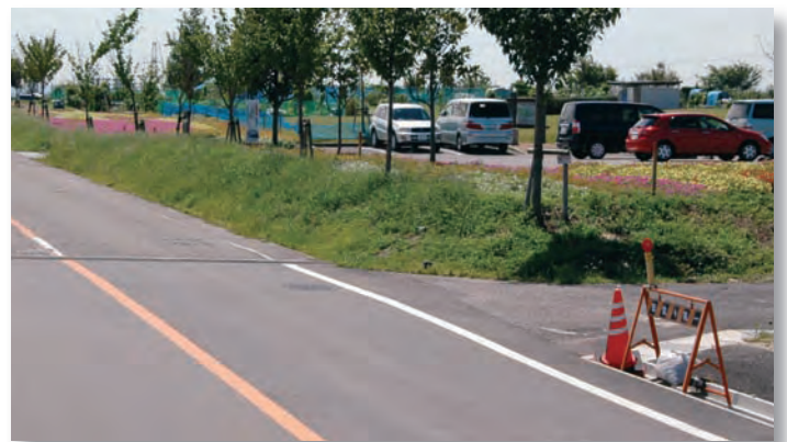
安全対策として現在、歩道整備の工事が行われているさんさんの郷東側の町道山ノ間小林線
