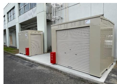
プロパンガスボンベ庫
