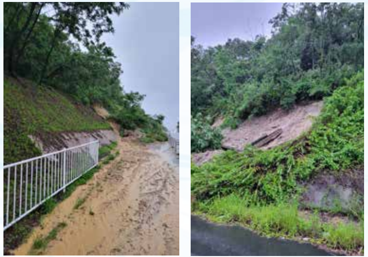
▲令和5(2023)年6月の大雨による被害の様子(福谷町地内)
