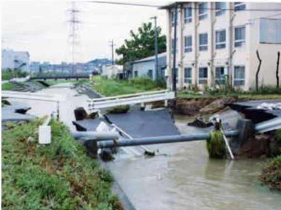
▲平成12(2000)年9月の東海豪雨による砂後川の被害の様子(三好町地内)
