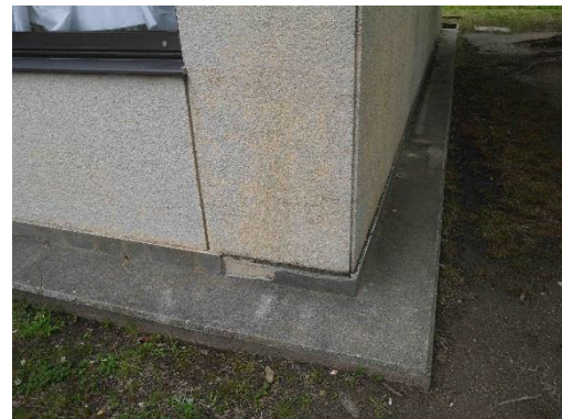
基礎モルタル 基礎のモルタル部分に割れが見られる箇所があります。
