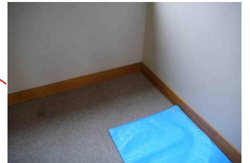
ホール床 ホール床に雨漏りの跡が見られます。
