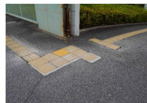
誘導ブロック 門扉付近の誘導ブロックに浮きが見られます。
