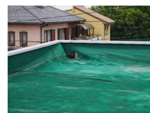
屋上防水 防水に膨れなどが見られます。
