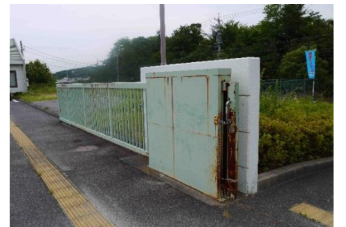
門扉 門扉鉄部に塗装の劣化、錆が見られます。
