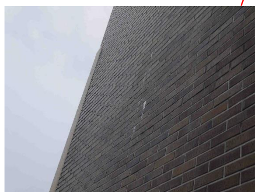
外壁タイル 一部白華らしき箇所が見られます。
