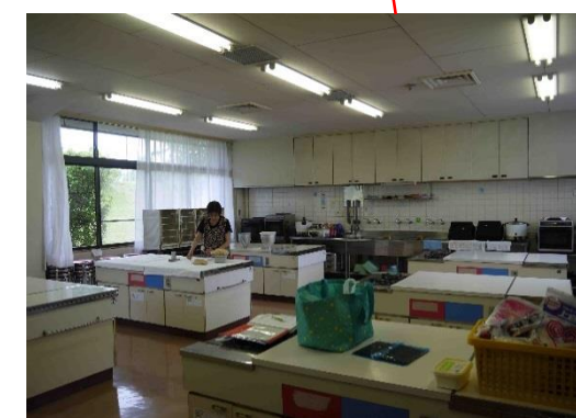
調理研修室 調理研修室の調理台の流しから水漏れがする箇所があります。
