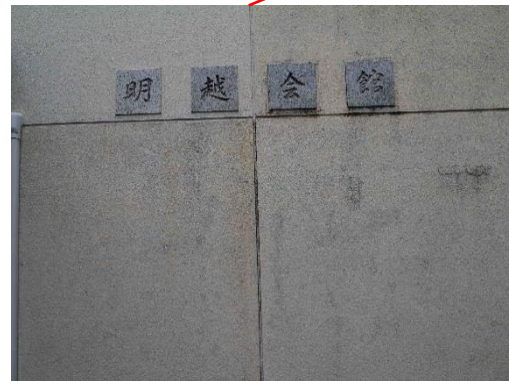
外壁 外壁に劣化・割れが見られ、一部浮きが見られる箇所もあります。
