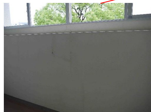
内壁 内装各所に劣化が見られます。 (画像は階段踊場)
