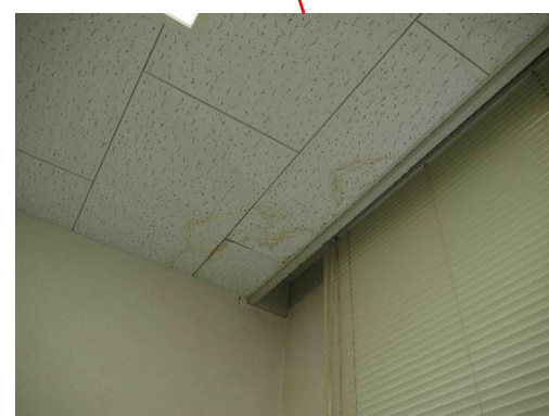
201 会議室 天井に雨漏りの跡が見られます。
