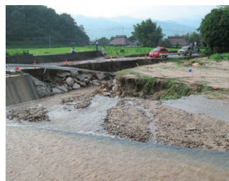
河岸の崩落により壊れたガードレール
