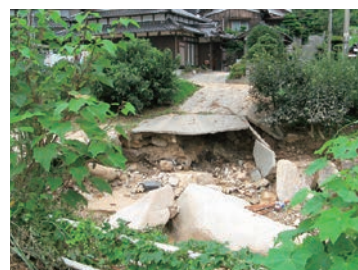
破壊された道路
