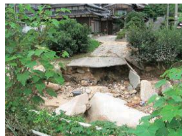
破壊された道路
