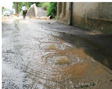
側溝から噴き出す水
