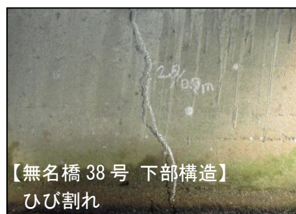
写真-5.5 損傷状況（下部構造）
