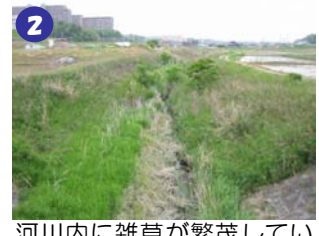
河川内に雑草が繁茂している状況にある。
