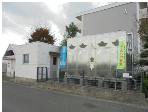
LPガス貯蔵庫・ポンプ室・給水タンク
