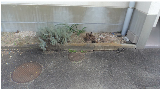
マンホール蓋の錆
