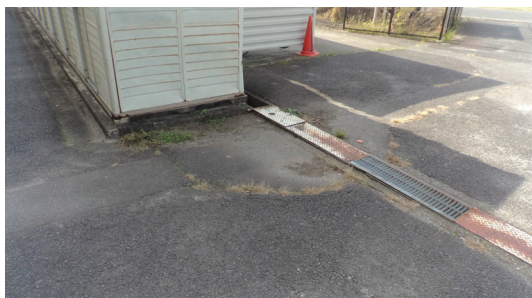
排水溝周りのグレーチングの錆
