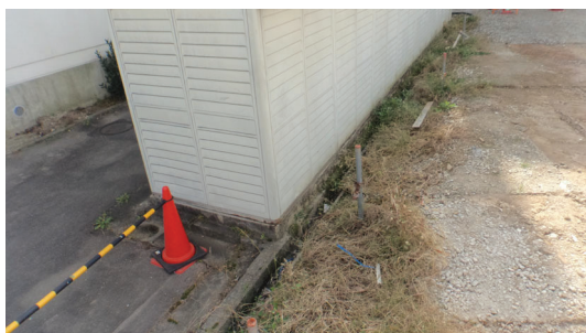
敷地周りの側溝の土砂堆積
