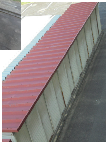
物置（屋根は改修されているが、扉に錆）
