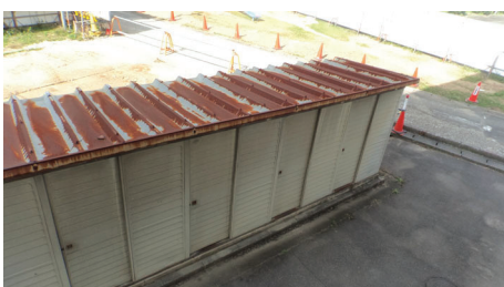
物置（屋根が錆で劣化）
