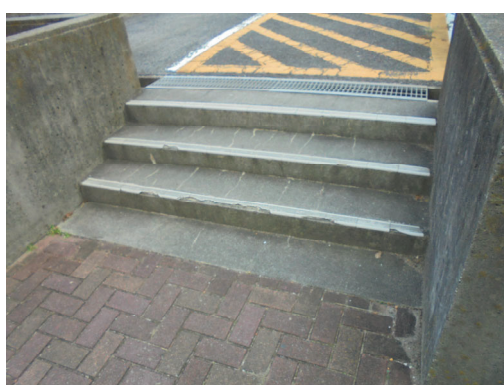
駐車場で入口の階段踏面の損傷
