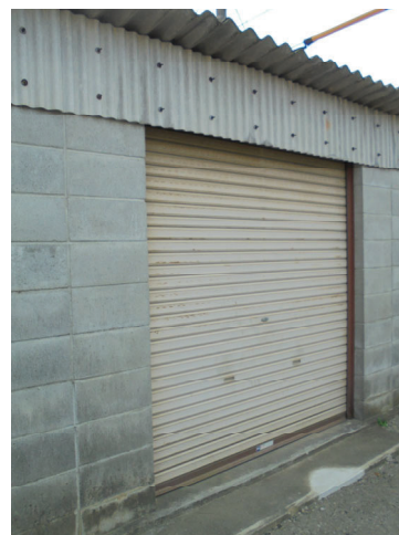
倉庫（シャッターに若干の錆）
