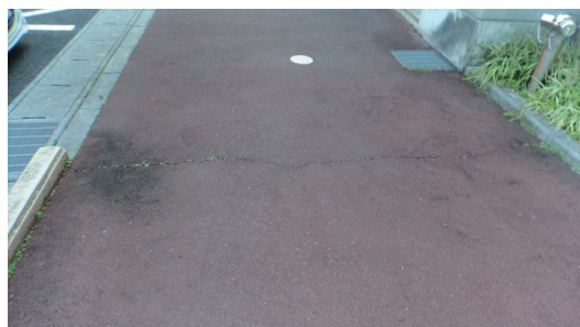
屋外通路（舗装にヒビがみられる）
