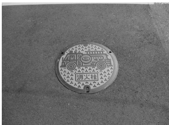
地下式消火栓
