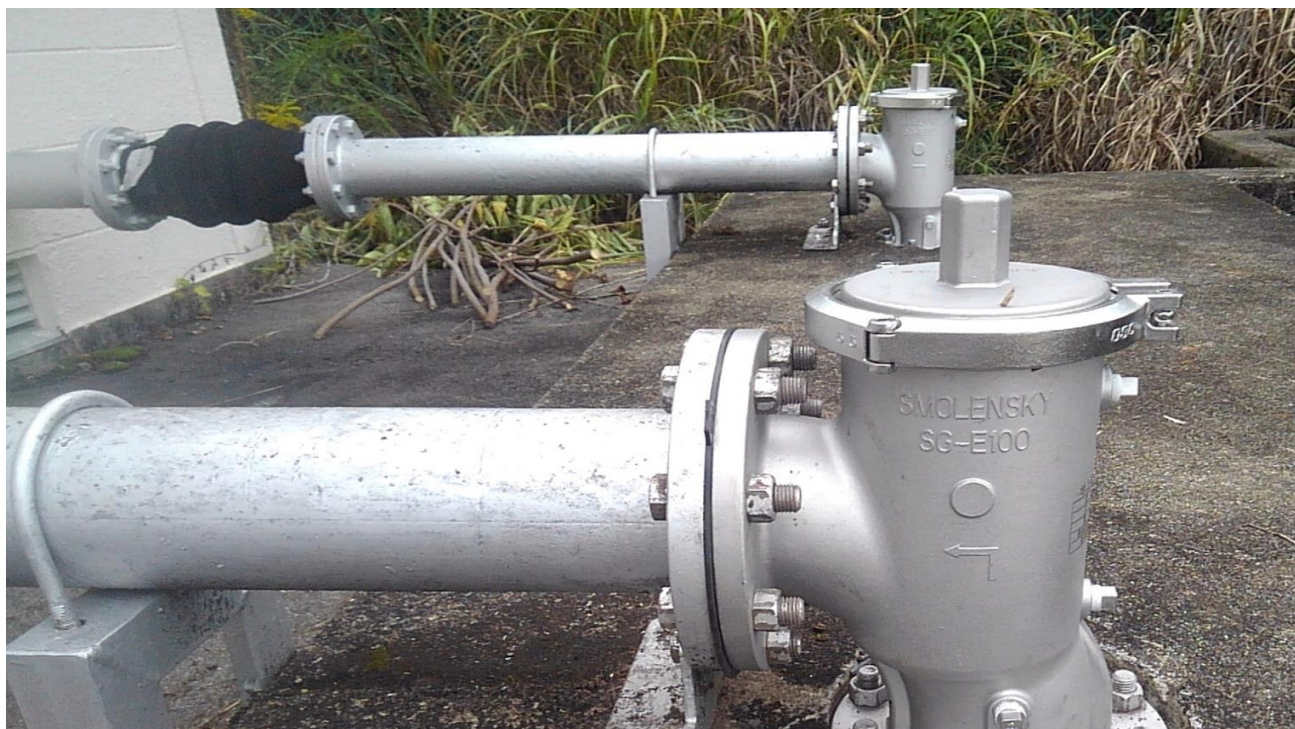
四ツ池ポンプ場の揚水ポンプ(苅生町)
