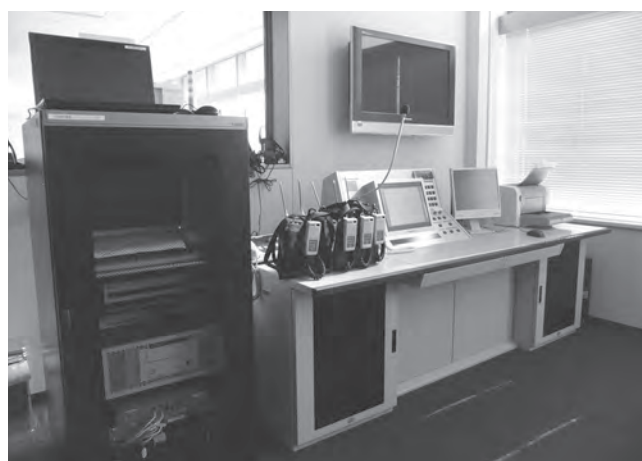
◎防災無線室の状況
