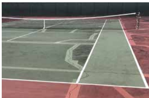
テニスコート表面の状況(亀裂と剥離)
