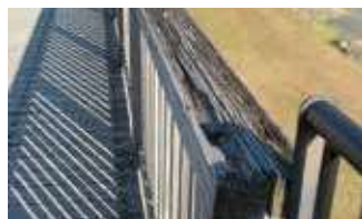
市内木部劣化例
