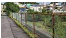
錆びたフェンス
