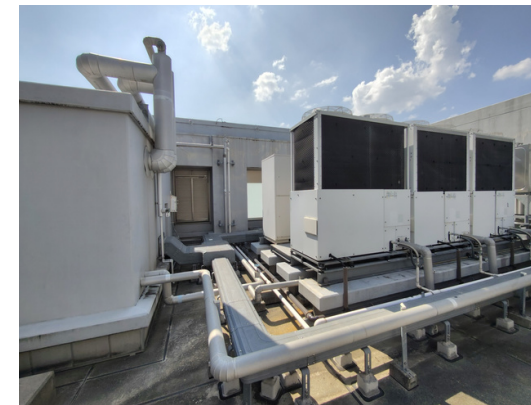
市役所庁舎（室外機）
