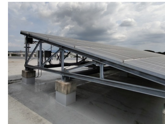
みよし市民病院（太陽光パネル）
