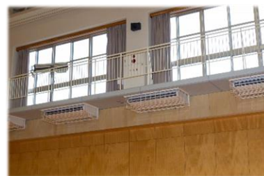
体育館に設置された空調機器
