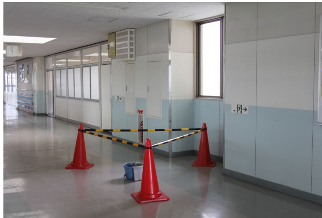
3階雨漏れ状況写真
