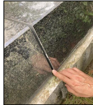
作品上部の溶接剥離
