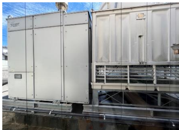
吸収式冷温水発生機
