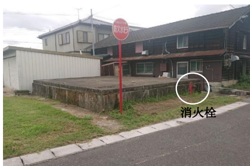
消火栓および防火水槽
