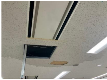
【天井部水漏れ】
