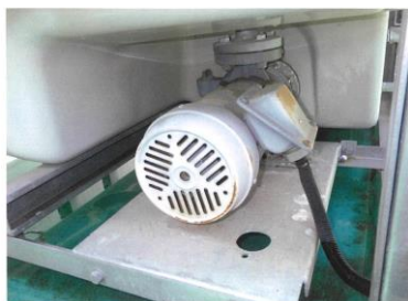
【冷温水器不良部品】
