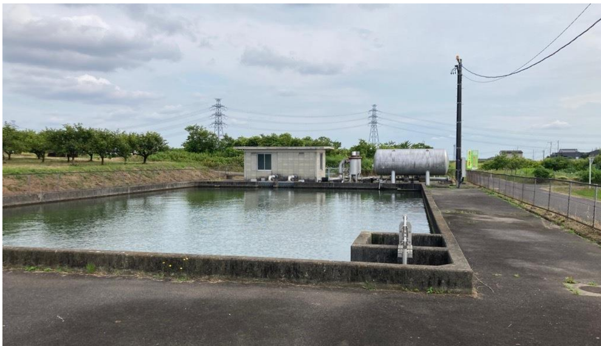
ポンプ場(明知上第二用水機場)
