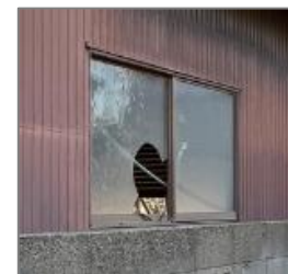
窓が割れた管理不全空家
