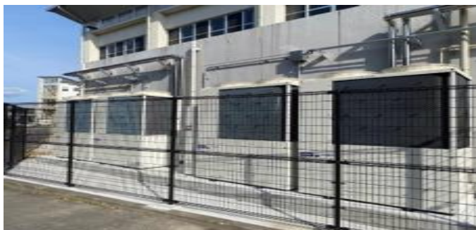
↑【空調機用室外機】
