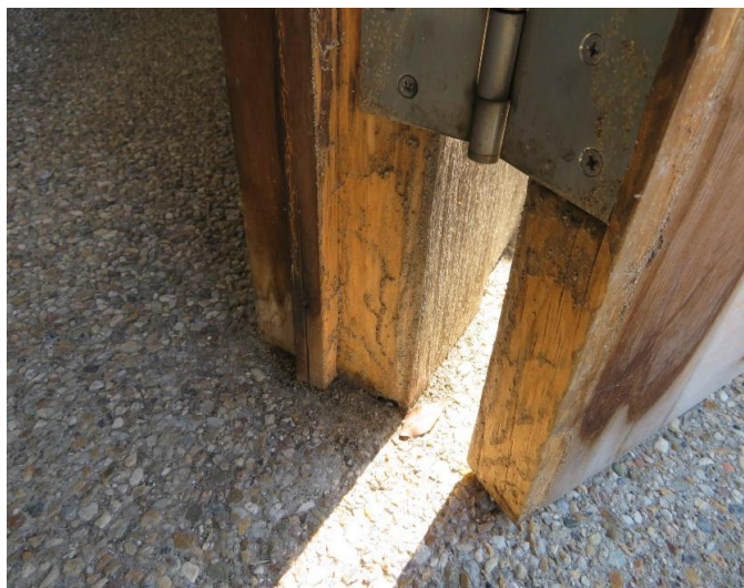
シロアリによる食害箇所
